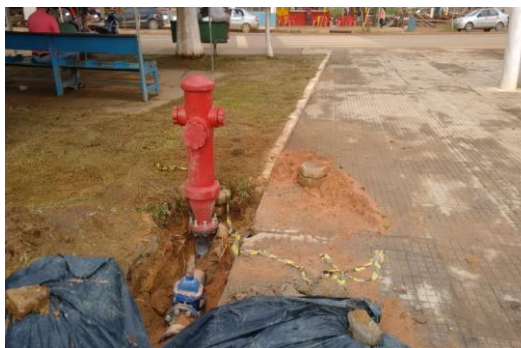
Foto 02: Hidrante instalado na antiga praça dos caminhoneiros.
